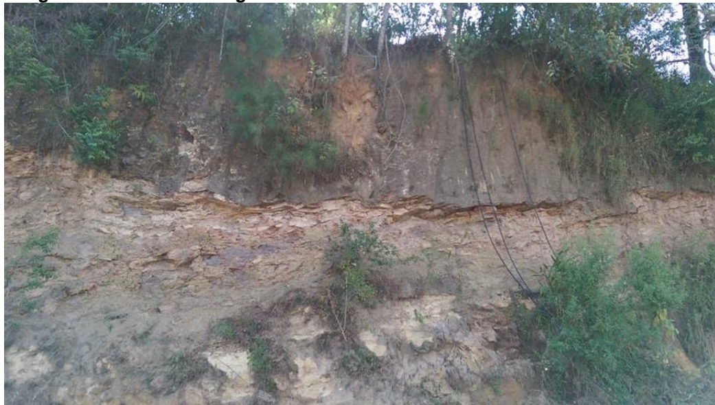
Figura 25: Cicatriz de escorregamento em talude na Estrada dos Guararapes, margem direita do Rio Tibagi.
